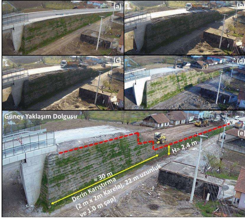
Şekil 10. KMO U48 Köprüsü Güney Geotarme Yaklaşım Dolgusunun Kontrollü Olarak Kazılması (a) Kazı Öncesi (b-d) Kontrollü Kazı İşlemi (e) Kazı İşleminin Tamamlanması
