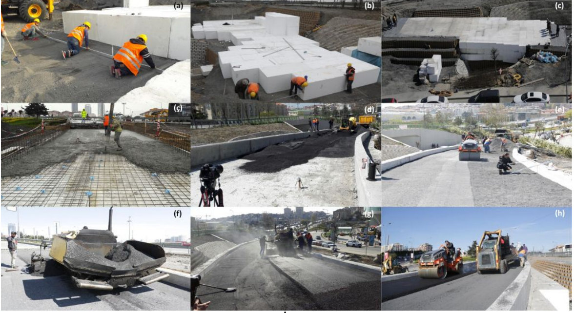
Şekil 5. Geofoam Blok Yol Dolgusunun İmalat Aşamaları (a) Temel Tesviye Kum Tabakası Serilerek Blok Yerleşimine Başlanması (b-c) Blok Yerleşim Planına Göre İmalatın Tamamlanması (ç) Betonarme Yük Yayma Platformunun İnşası (d-f) Yol Alt Temel/Temel Malzemesinin İki Kademede Serilerek Sıkıştırılması (g-h) Alt Temel Üzerine Sıcak Kaplamanın İmalatı
